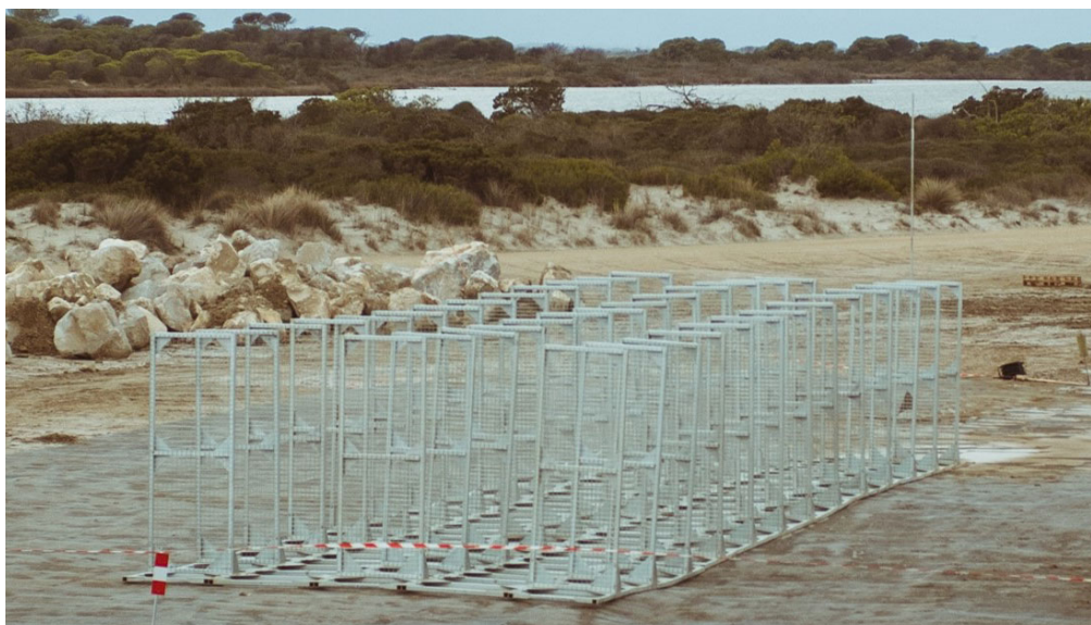
Structure métamatériau installée aux Salins du Midi
